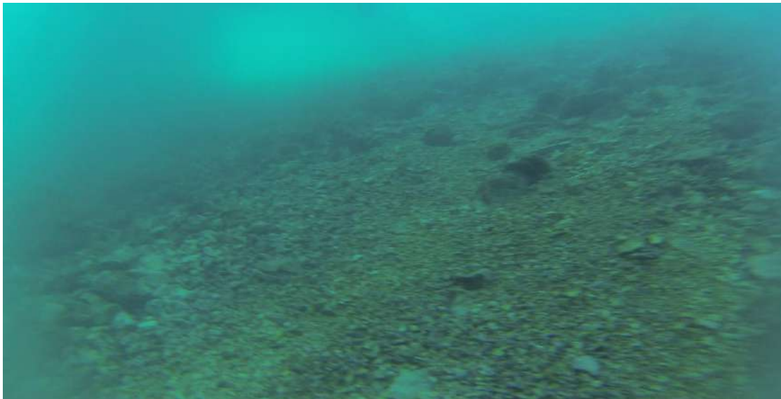
Slika: početak lukobrana točnije od 0-20m lukobrana nasip čini sitni kamen. Izvor: Elaborat „Podvodni pregled stanja kamenometa (školjere) lukobrana - Pješćana Uvala“, Murgons d.o.o., Pula, veljača 2020.
