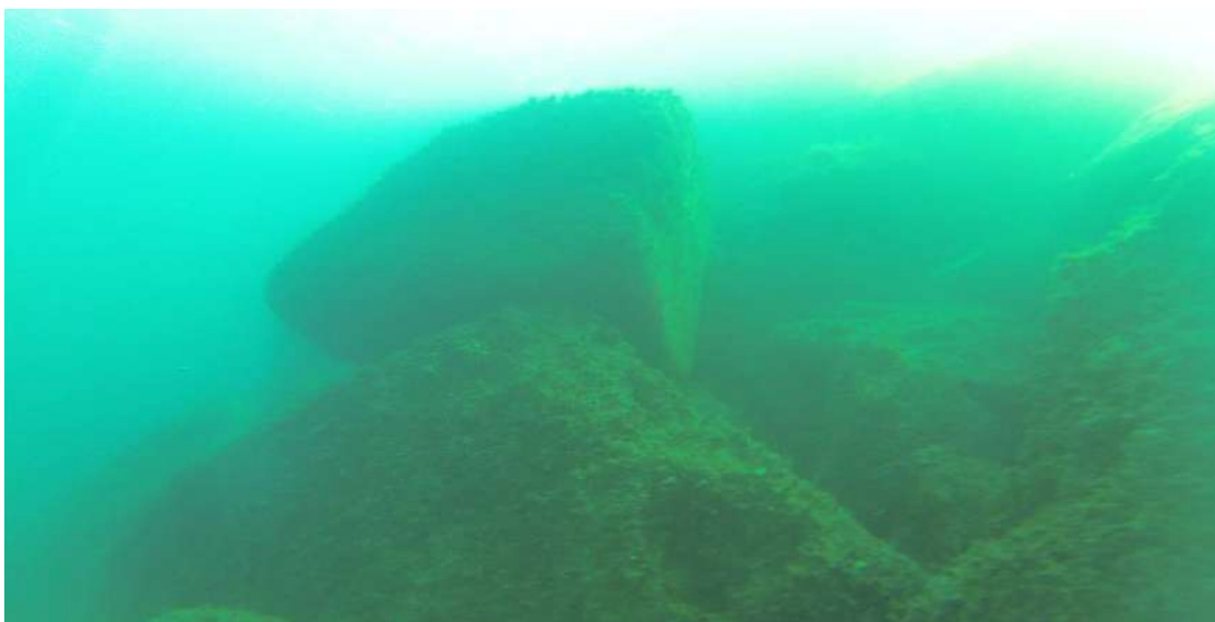
Slika: Od 20og metra lukobrana pa sve do same glave lukobrana, nasip je izgrađen od velikih kamenih blokova, promjera 1,5 - 2m. Izvor: Elaborat, Podvodni pregled stanja kamenometa (školjere) lukobrana - Pješćana Uvala“, Murgons d.o.o., Pula, veljača 2020.
